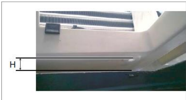
Рис. 11: Зазор между основанием кондиционера и крышей.
